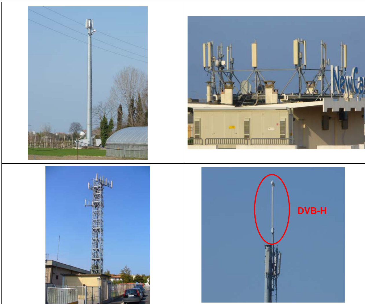
Figura 2: Esempi di SRB e DVB-H installati nel Comune di Cesenatico
